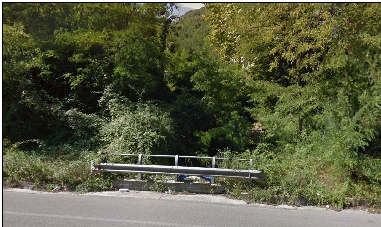
Figura 7.5 – Attraversamento sulla s.p. 20 del Canale della Fredda. Si nota la vegetazione notevolmente sviluppata anche in alveo.
