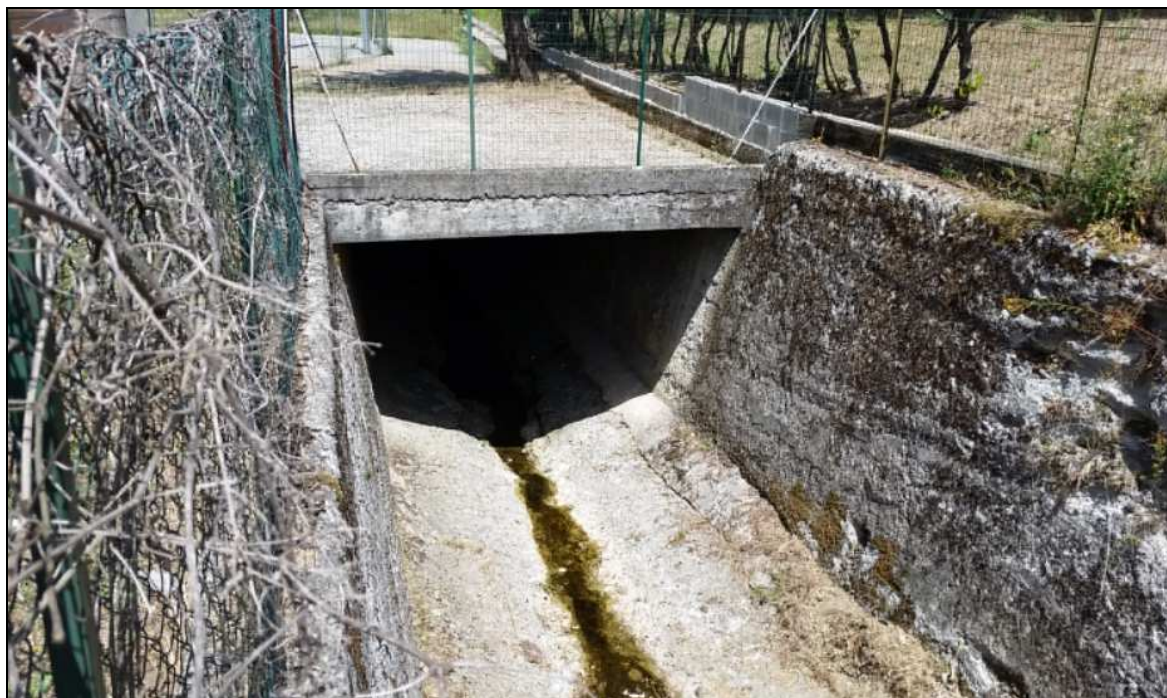
Figura 7.17 – Imbocco del tombamento sul fosso Canalaccio a monte del polo scolastico
